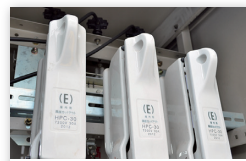
④ 高圧カットアウト
