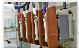
⑨ 計器用変圧器
